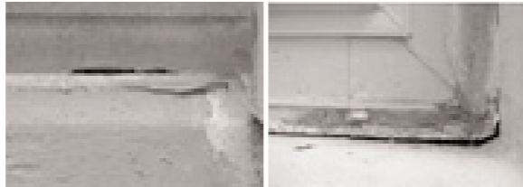
▶ 발코니 하부 누수(누수유형의 65% 차지)
