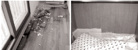
▶ 후면 발코니 도장 박리 ▶ 발코니 창고 내용을 오염
