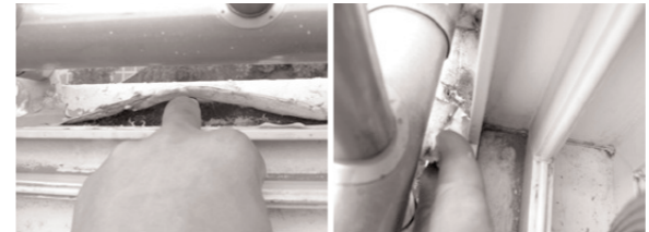
▶ 실란트 박리 및 균열
