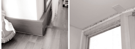
▶ 발코니 온돌마루 변색 ▶ 사시 이슬맺힘 및 벽면 곰팡이 발생
