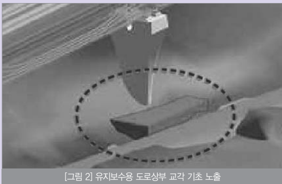
[그림 2] 유지보수용 도로상부 교각 기초 노출
