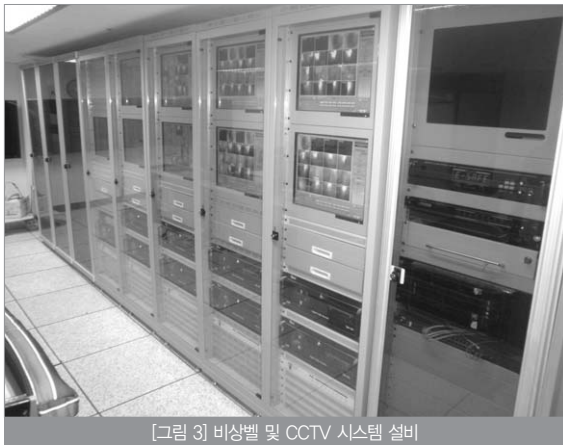
[그림 3] 비상벨 및 CCTV 시스템 설비
