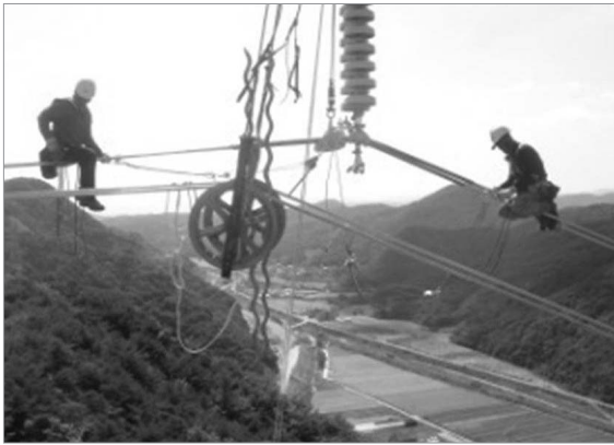
③ 중심점이 일치하지 않을 경우 일체형 후크의 전선클램프를 전력선에 고정시킨다.
