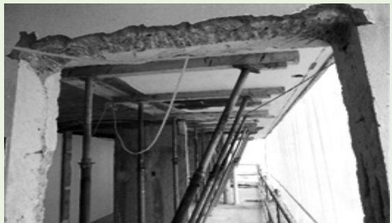
[그림 1] 캔틸레버보 철거로 인한 슬래브 처짐 및 서포트 설치현황
