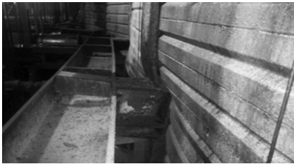
(a) 가시설 변위 발생(보강 전)
