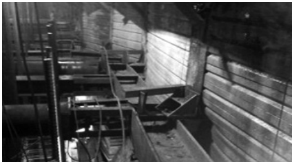
(b) 가시설 변위 발생(보강 후)
